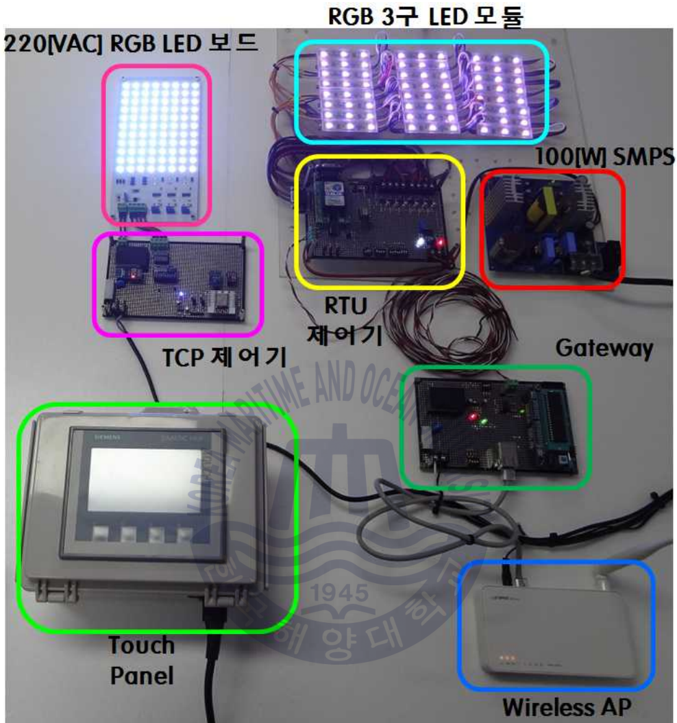
Fig. 65 Modbus 감성조명 제어시스템의 연동 실행모습
